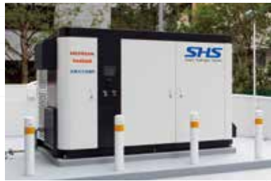
スマート水素ステーション (SHS)
